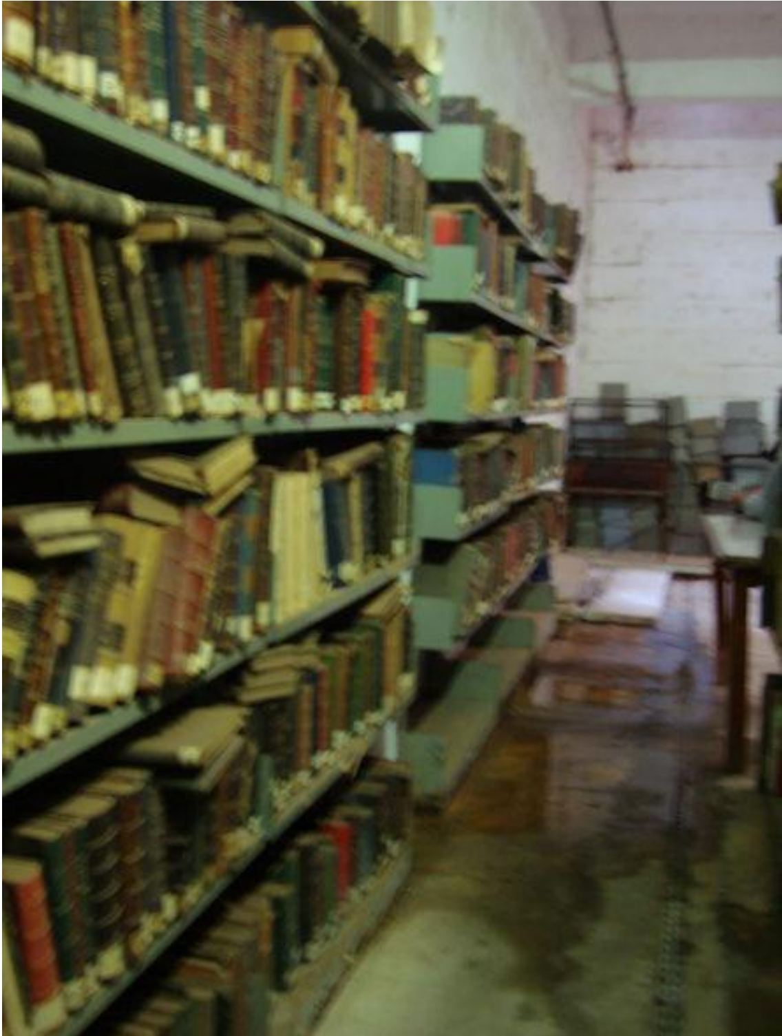
Parede do subsolo da BCE com livros deteriorando entre goteiras e poças d'água (especificamente a coleção de Baleeiro)
